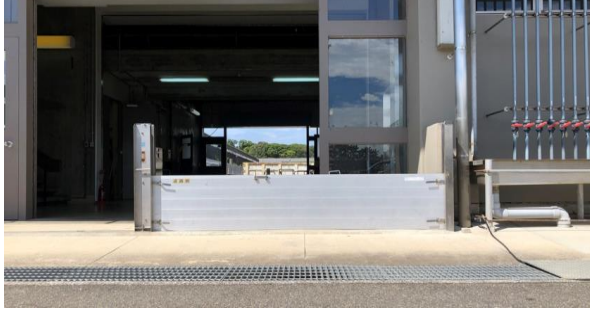
既存浸水防止パネル（猪名川浄水場）
