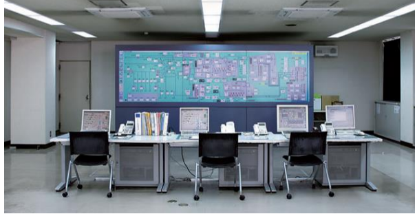
センター設備
