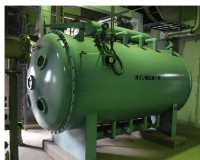
オゾン発生器（猪名川浄水場）
