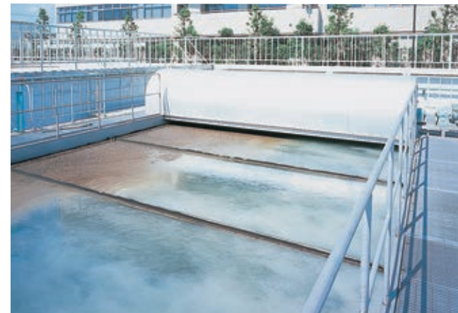
浮上分離設備
