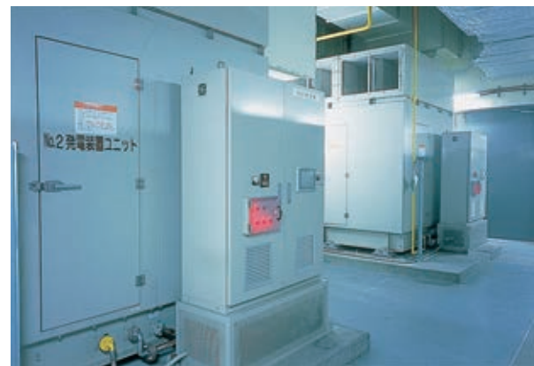
発電装置ユニット
